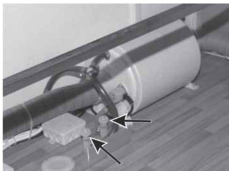
Fig. 99: Chauffe-eau TRUMA et vannes de vidange d'eau
