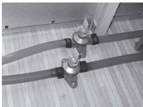
Fig. 102: Vannes de vidange ouvertes
