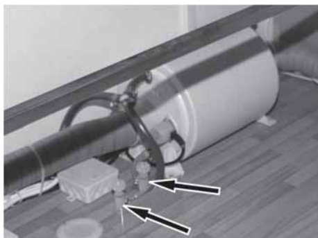
Fig. 176: Vannes de vidange
