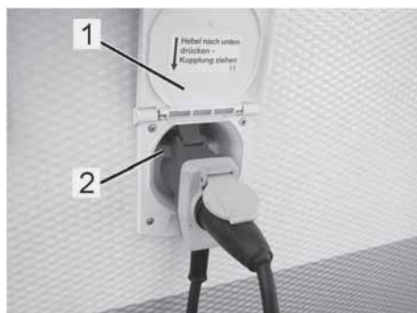
Fig. 60 : Branchement sur le secteur
