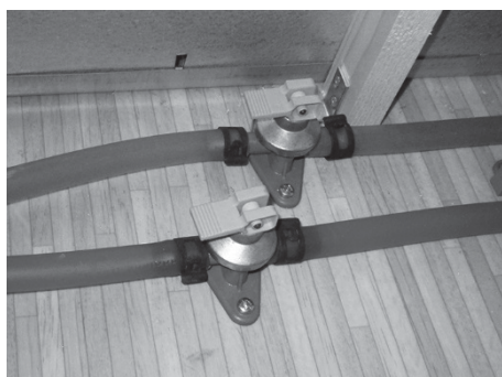
Fig. 179: Vannes de vidange fermées
