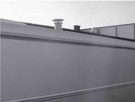
Abb. 82: Abgaskamin der Gasheizung
