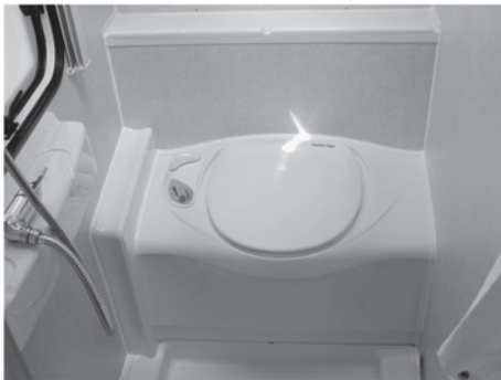
Abb. 44: Toilette, Beispiel fest installiert
