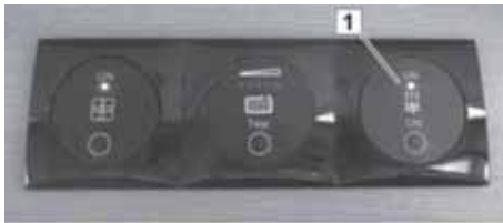
Abb. 134: Ein-/Aus-Schalter der Fußbodentemperierung
