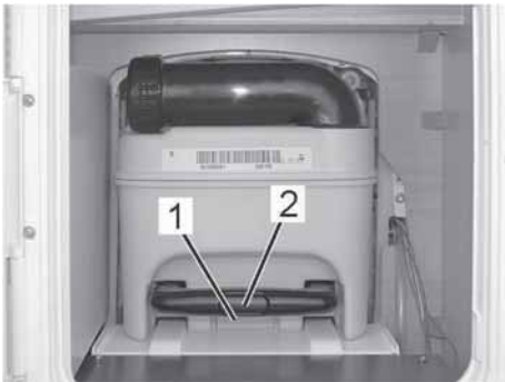
Abb. 193: Fäkalientank im Entsorgungsschacht
