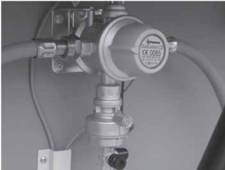
Abb. 76: Gasversorgung (mit Eis-Ex und Fernanzeige)
