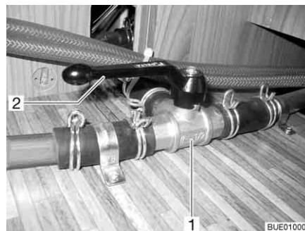
Fig. 139 Válvula de 3 vías
