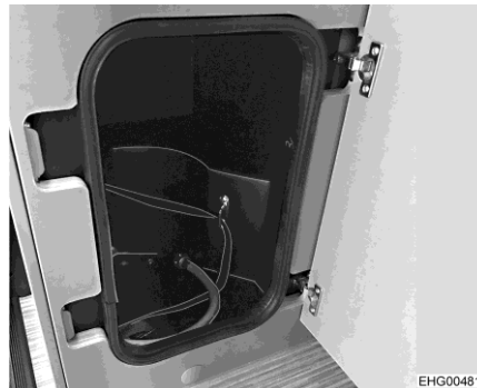
Fig. 29 Compartiment à gaz
