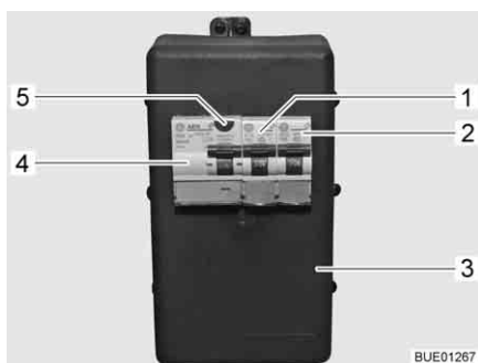
Billede 165 230 V-sikringskab med sikkerhedsafbryder og HFI-afbrydere
