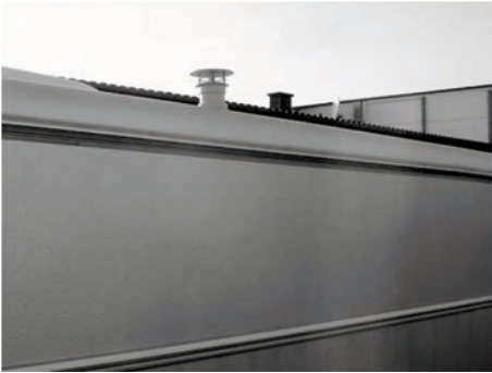
Fig. 85: Conduit d'évacuation des gaz brûlés du chauffage à gaz
