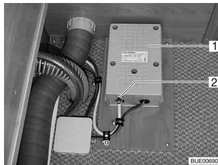
Fig. 132 Trasformatore per riscaldamento elettrico del pavimento
