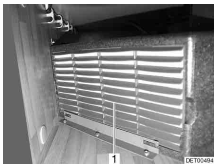
Fig. 206 Impianto di climatizzazione (Truma)
