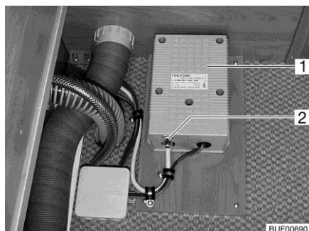
Billede 147 Transformator for elektrisk gulvopvarmning
