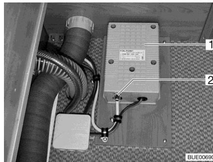
Fig. 147 Trasformatore per riscaldamento elettrico del pavimento
