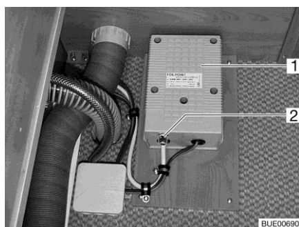
Bild 147 Transformator för elektrisk golvvärme
