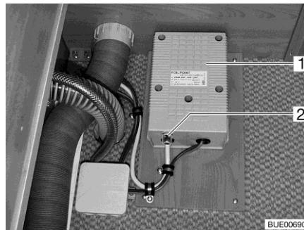
Afb. 147 Transformator voor de elektrische vloerverwarming
