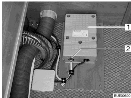
Afb. 168 Transformator voor de elektrische vloerverwarming
