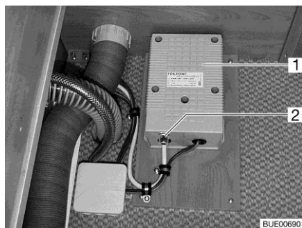
Fig. 168 Trasformatore per riscaldamento elettrico del pavimento
