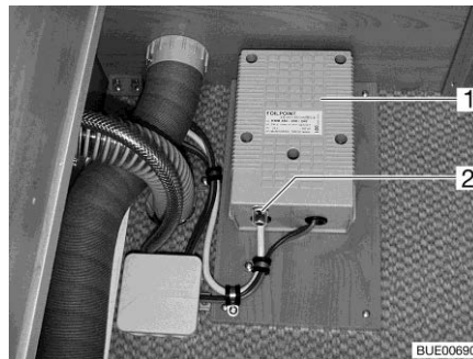
Bild 223 Trafo für elektrische Fußbodenerwärmung
