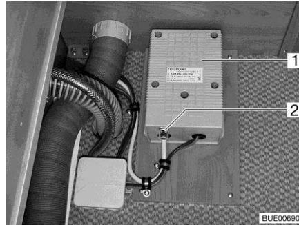
Fig. 120 Trasformatore per riscaldamento elettrico del pavimento
