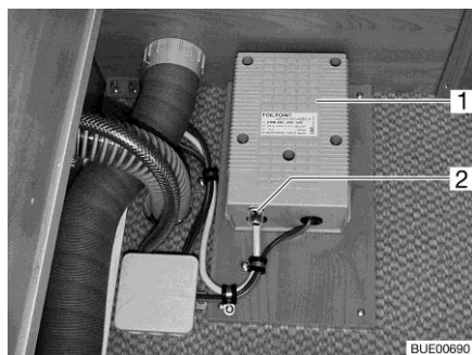
Billede 120 Transformator for elektrisk gulvopvarmning
