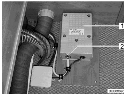
Billede 233 Transformator for elektrisk gulvopvarmning
