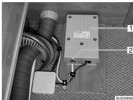
Fig. 233 Transformador para calentamiento eléctrico del piso
