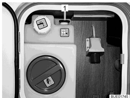
Fig. 257 Serbatoio dell'acqua (unità di servizio)
