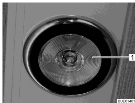
Bild 98 Infälld lampa, ljusbrytare i lampan
