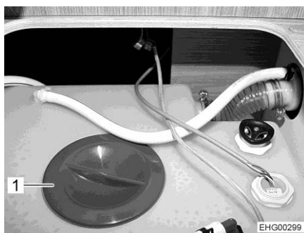
Bild 280 Rengöringsöppning på vattentanken
