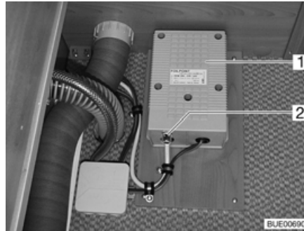
Bild 145 Trafo für elektrische Fußbodenheizung
