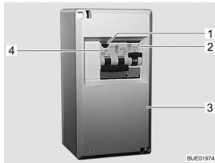
Billede 141 230 V-sikringskab med sikkerhedsafbryder og HFI-afbrydere
