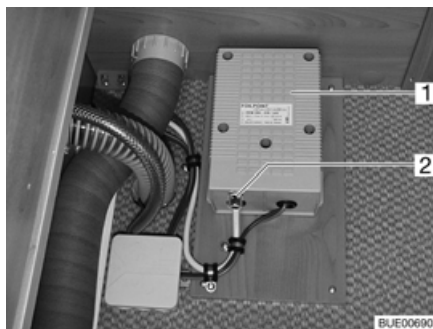
Billede 166 Transformator for elektrisk gulvopvarmning
