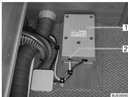
Fig. 166 Trasformatore per riscaldamento elettrico del pavimento
