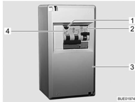
Fig. 147 Scatola dei fusibili a 230 V
