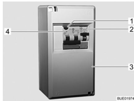
Bild 141 230 V-säkringslåda med ledningsskyddsbrytare och FI-brytare
