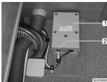
Bild 166 Transformator för elektrisk golvvärme
