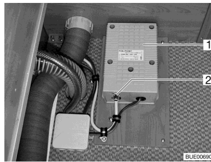
Afb. 220 Transformator voor de elektrische vloerverwarming
