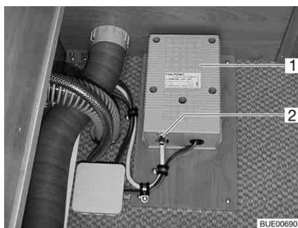
Fig. 193 Transformateur du chauffage électrique du plancher
