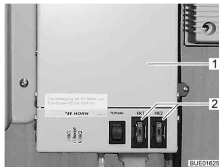
Fig. 167 Regulador de la calefacción para las tuberías de aguas residuales
