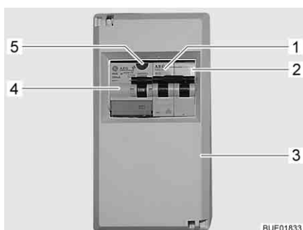
Kuva 161 230 V:n sulakerasia ja johdinsuojakytkin sekä FI-kytkin
