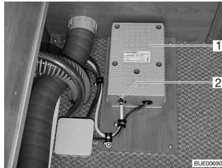
Kuva 193 Sähköisen lattialämmityksen muuntaja
