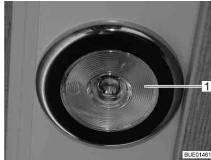
Bild 90 Einbauleuchte, Lichtschalter in der Leuchte
