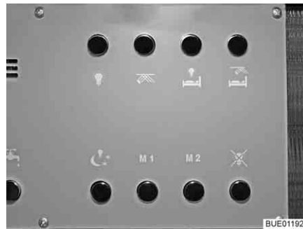
Fig. 94 Pannello di controllo
