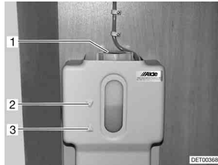
Fig. 251 Vaso d'espansione con diaframma
