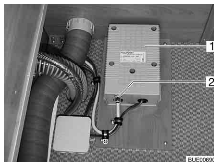
Bild 133 Transformator för elektrisk golvvärme
