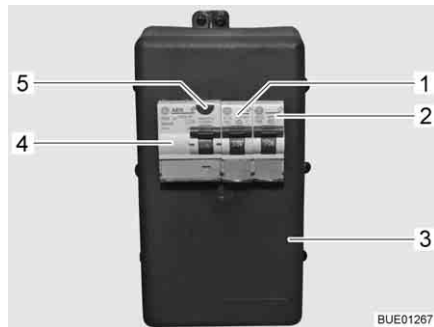
Billede 108 230 V-sikringskabinet med sikkerhedsafbryder og HFI-afbrydere
