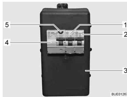
Bild 156 230-V-Sicherungskasten mit Leitungsschutzschalter und FI-Schalter
