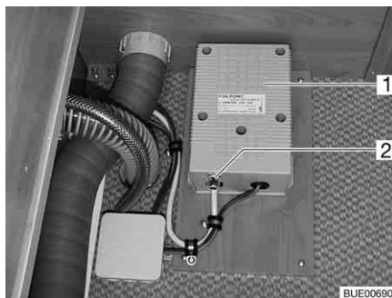
Afb. 193 Transformator voor de elektrische vloerverwarming
