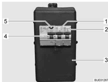
Afb. 156 230-V-zekeringenkast met beveiligingsautomaat en FI-schakelaar
