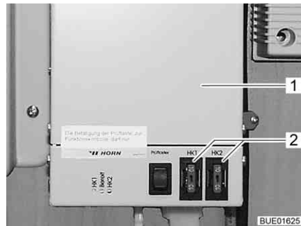
Kuva 164 Jätevesijohtimien lämmitys- säädin
