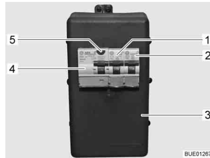
Kuva 118 230 V:n sulakerasia ja johdinsuojakytkin sekä FI-kytkin
