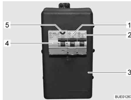
Billede 153 230 V-sikringsskab med sikkerhedsafbryder og HFI-afbrydere
