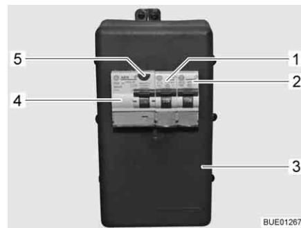
Billede 142 230 V-sikringskabinet med sikkerhedsafbrydere og HFI-afbrydere
