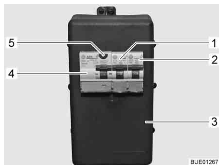
Kuva 109 230 V:n sulakerasia ja johdinsuojakytkin sekä FI-kytkin
