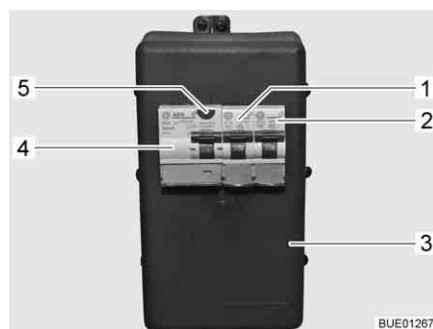
Bild 172 230 V-säkringslåda med ledningsskyddsbrytare och FI-brytare
