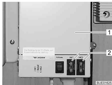
Bild 168 Regulator för avloppsledningarnas värmesystem
