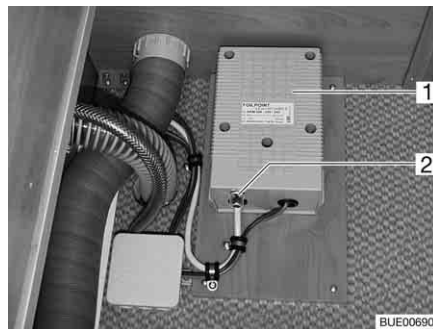
Bild 195 Transformator för elektrisk golvvärme
