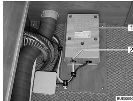
Afb. 205 Transformator voor de elektrische vloerverwarming
