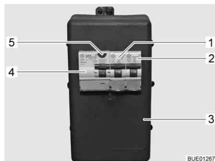
Afb. 139 230-V-zekeringenkast met beveiligingsautomaat en FI-schakelaar
