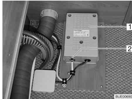
Fig. 199 Transformador para calentamiento eléctrico del piso
