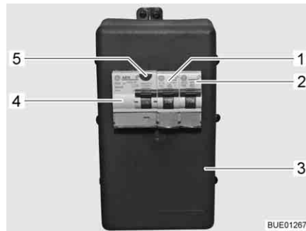
Fig. 176 Caja de fusibles de 230 V con interruptor de protección de línea e interruptor FI
