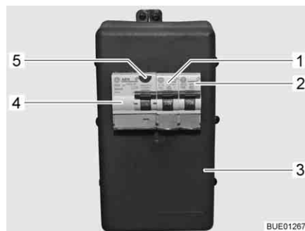
Fig. 165 Caja de fusibles de 230 V con interruptor de protección de línea e interruptor FI
