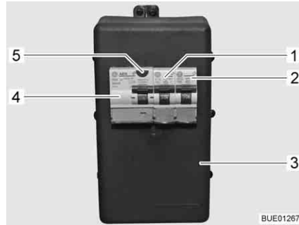
Afb. 165 230-V-zekeringenkast met beveiligingsautomaat en FI-schakelaar
