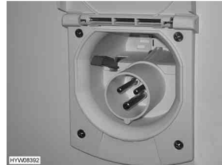
Afb. 166 230-V-aansluiting op het voertuig
