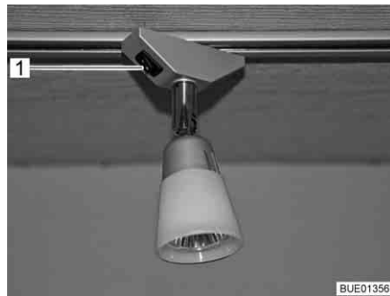
Fig. 41 Spot, interrupteur d'éclairage directement sur la lampe
