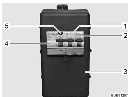
Fig. 96 Scatola dei fusibili a 230 V con interruttore di sicurezza e interruttore automatico FI
