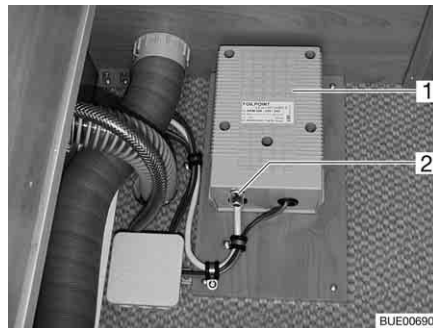
Kuva 199 Sähköisen lattialämmityksen muuntaja
