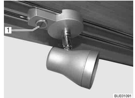
Billede 58 Spotlampe, lyskontakt direkte ved lampen
