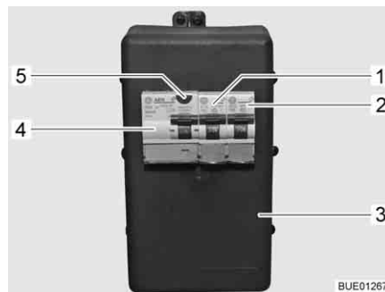
Billede 189 230 V-sikringsskab med sikkerhedsafbryder og HFI-afbrydere
