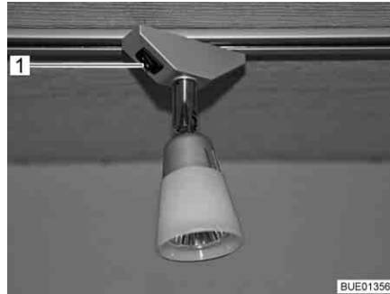
Billede 57 Spotlampe, lyskontakt direkte ved lampen
