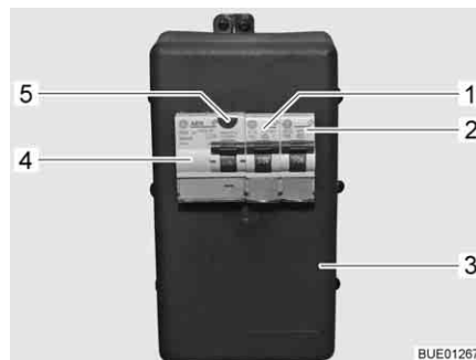
Bild 189 230 V-säkringslåda med ledningsskyddsbrytare och FI-brytare
