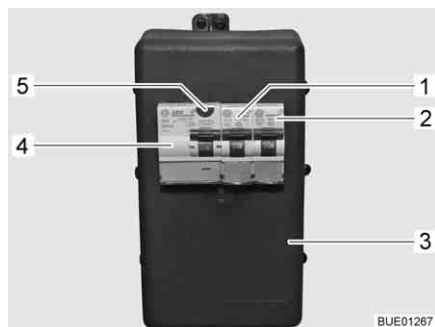
Kuva 178 230 V:n sulakerasia ja johdinsuojajakytkin sekä FI-kytkin
