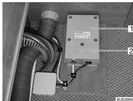
Kuva 211 Sähköisen lattialämmityksen muuntaja
