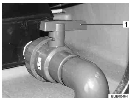
Billede 181 Aftapningshane (i den dobbelte bund)
